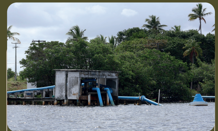
Estrutura de bombas de captação de água para os tanques de camarão, Ouricuri.
